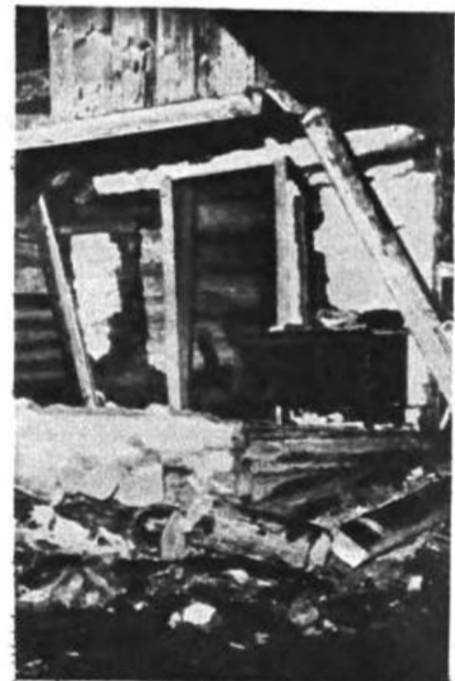
Крестьянский дом, разрушенный взрывом баллона.
