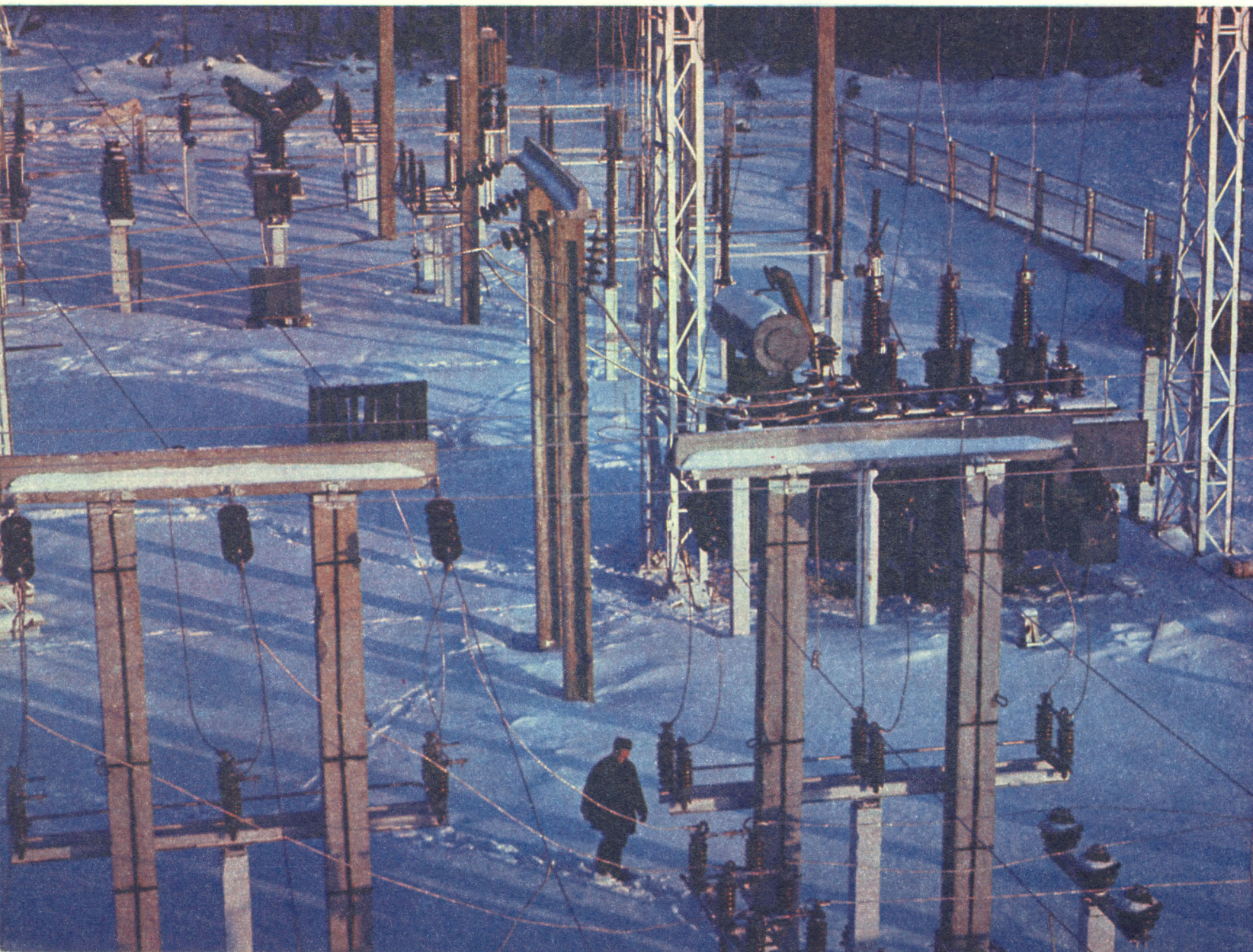
О таких подстанциях сельские электрификаторы и не мечтали. А теперь на берегах Байкала вырастают сложные сооружения.
