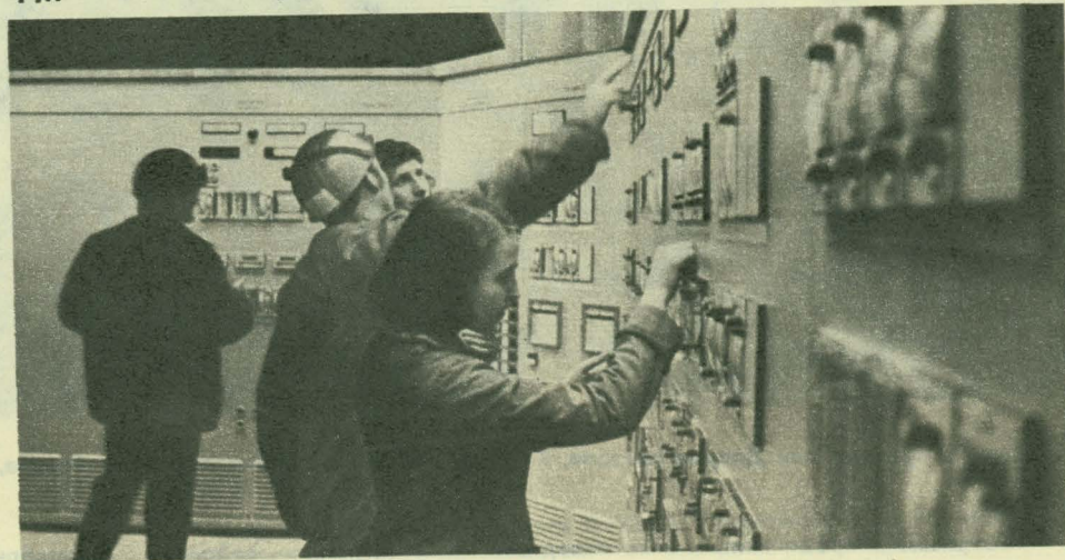
А здесь его сердце — центральный пульт управления
