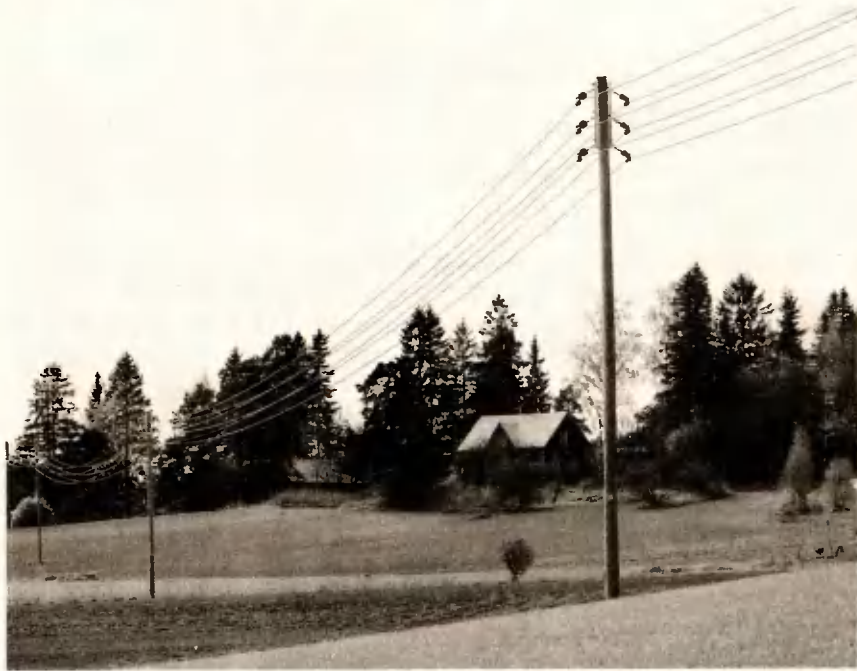
Рис. 13.39. Двухцепная линия напряжением 6...10 кВ (промежуточные опоры)
