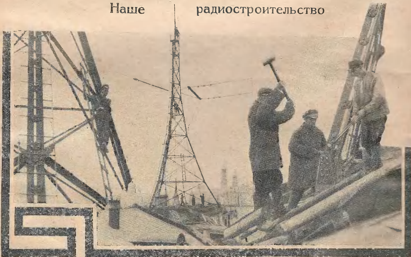
Производство работ по сооружению железной мачты для антенны на здании Н. К. П. и Т. в Москва.
