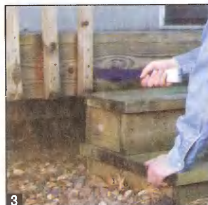
3 Устранение сгнившей древесины не дает распространиться гнили дальше.
