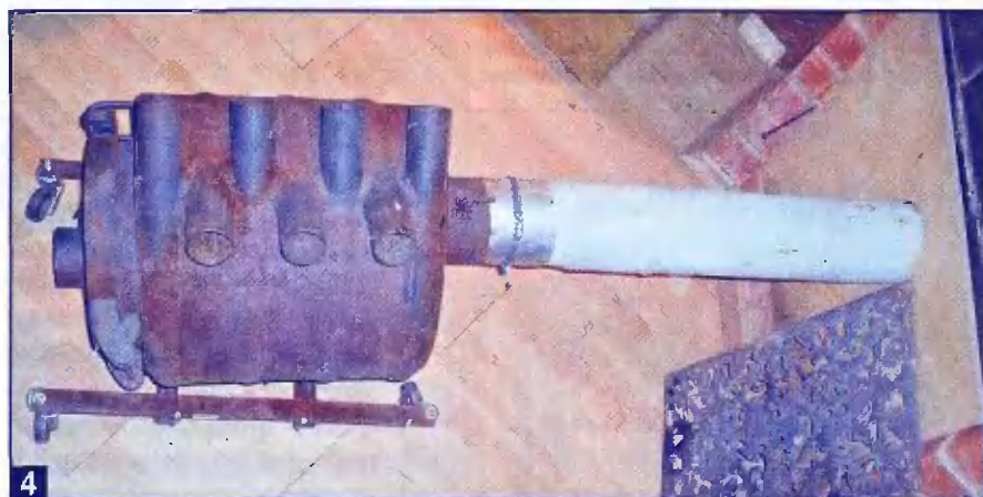
4 Выходной дымовой патрубок печи с камином соединен отрезком асбоцементной трубы \varnothing 100 мм и длиной около 1 м.
