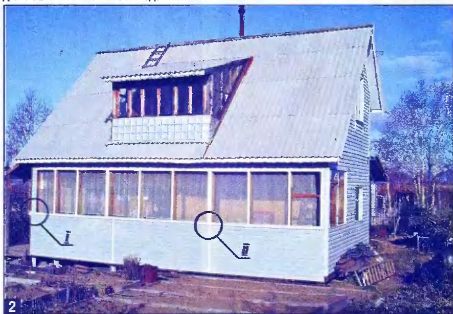
2 Дача после отделки фронтона и фасада сайдингом и оформления окон веранды пластиком. Сентябрь 2006 года. Узлы I и II показаны на рис. 1, 2.
