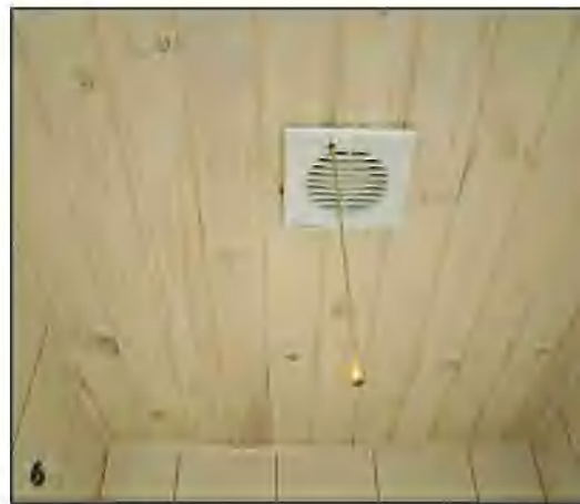
Выключатель принудительной вентиляции. Включение вентилятора совмещено с включением светильника, но если в вентиляторе в данный момент нет необходимости, его можно отключить, потянув за шнурок.
