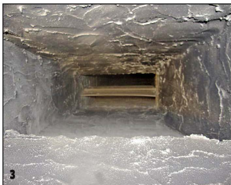
В начале дымохода установлен поворотный шибер.
