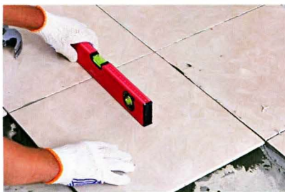
Контролировать правильность укладки плиточного покрытия удобно с помощью пузырькового уровня длиной около 1 метра.
