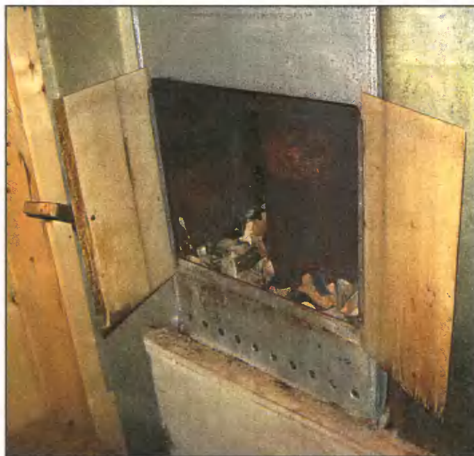
Каменка с открытыми дверками — вид из парной. В качестве наполнителя в каменку загружены колотые фарфоровые изоляторы.
