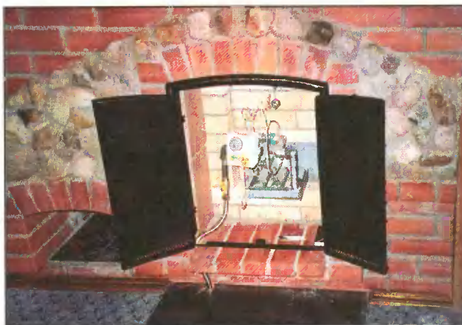
Газогорелочное устройство с автоматикой безопасности печи.
