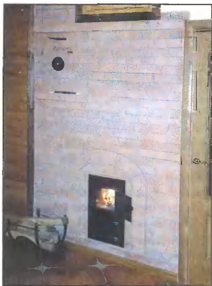
Металлическая печь в кирпичной облицовке и с отопительным щитком. Вид на печь из комнаты отдыха.
