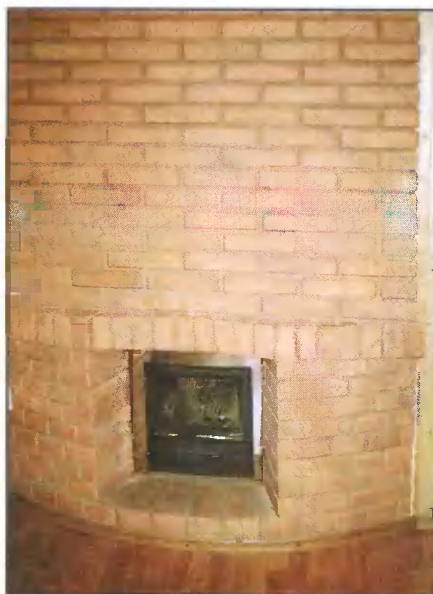
Металлическая печь «Harvia», обложенная кирпичом. Вид из комнаты отдыха. Кладка выполнена из красного кирпича марки М-200.
