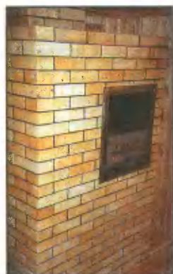
Вид на печь-каменку из парной.
