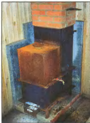
Печь топилась из парной и установлена была со всеми необходимыми зазорами. Но это — единственное, что было сделано правильно.
