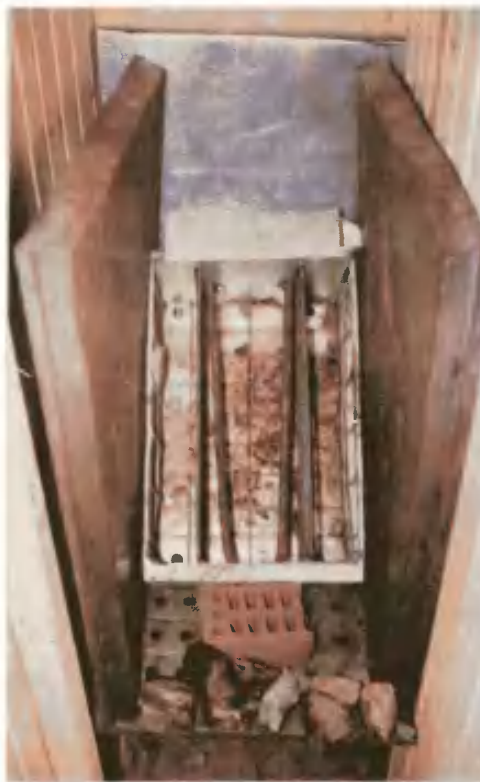
Теплоэлектронагреватели, вмонтированные в ящик.
