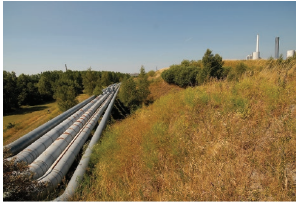
Калуннборг: трубы, по которым отработанный пар с электростанции DONG Energy передается компаниям для использования его в производственных целях
