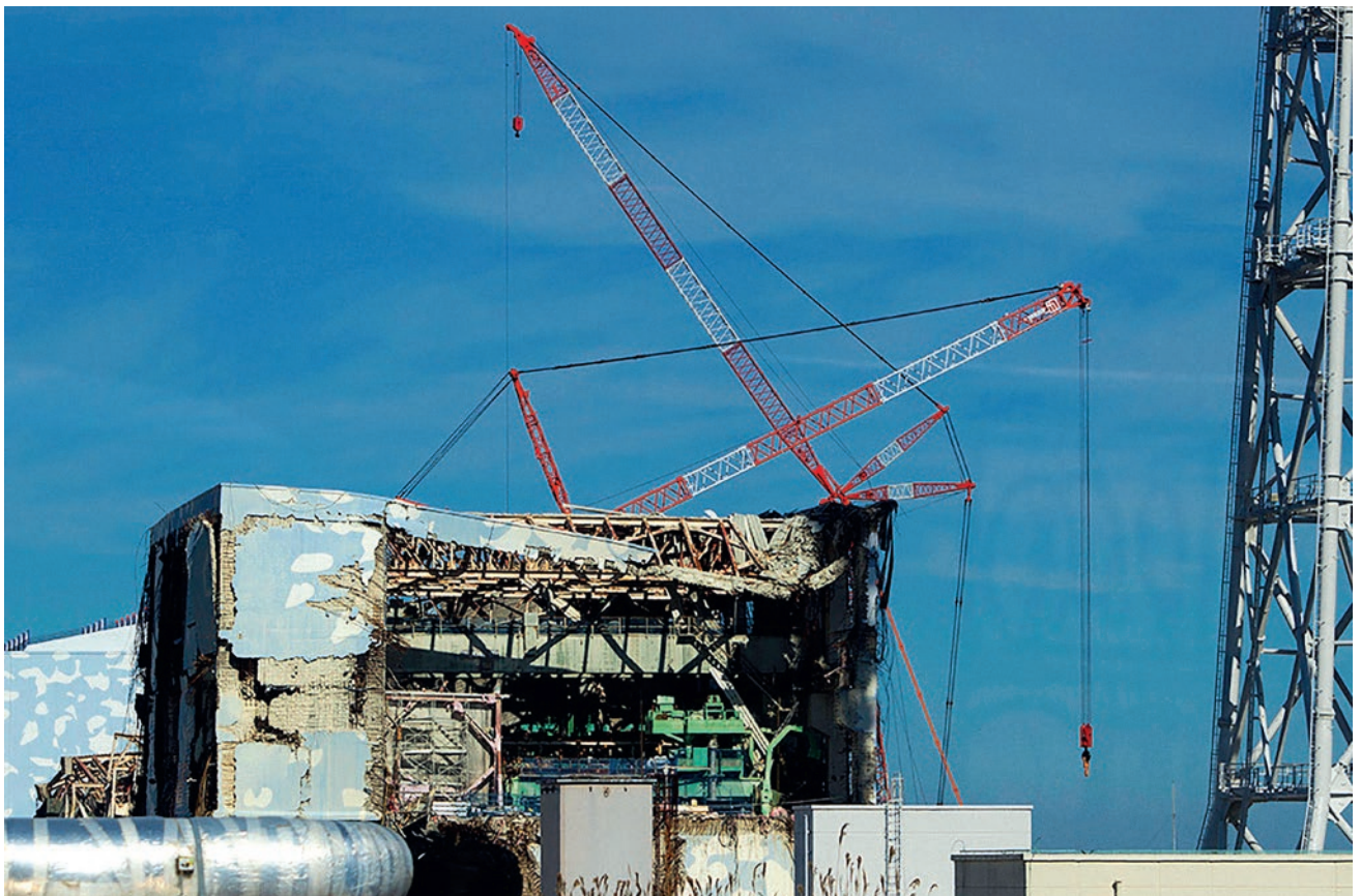
Разрушенный энергоблок № 4 АЭС «Фукусима-1», 12 ноября 2011 г. Источник: Дэвид Гуттенфельдер / Associated Press.
