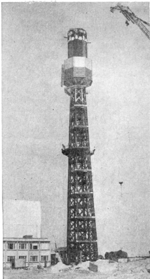
Общий вид 70-метровой башни солнечной электростанции СЭС-5. На башне установлен круговой парогенератор. Слева от башни — машинный зал, где находится турбогенератор
