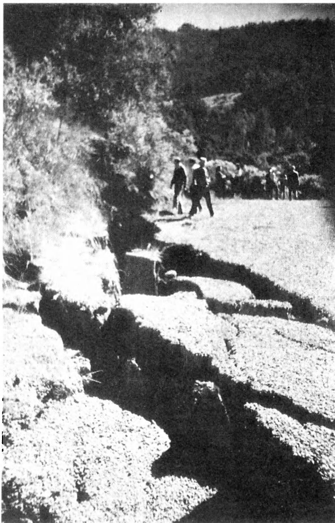
Трещины в грунте, образовавшиеся в эпицентральной зоне землетрясения Лома-Приета Фото В. Г. Кособокова
