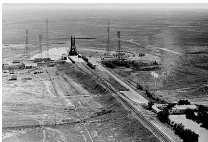
Стартовая площадка № 1 на космодроме Байконур, откуда были запущены первые спутники и пилотируемые корабли: во время строительства и после его окончания. 1956–1957 гг.
