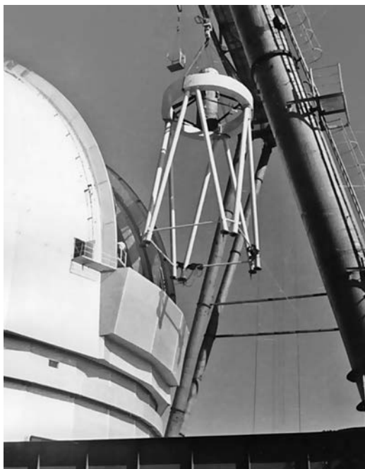
Монтаж верхней части трубы БТА с кабиной первичного фокуса в башню Обсерватории. Осень 1974 г.
