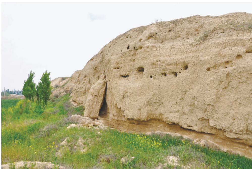
Рис. 12. Послойное, субпараллельное склону отседание блоков стены по трещинам, образовавшимся во время сильного древнего сейсмического события. Северная часть первого шахристана. Вид на северо-восток. Фото А.М. Корженкова, 2019 г.
