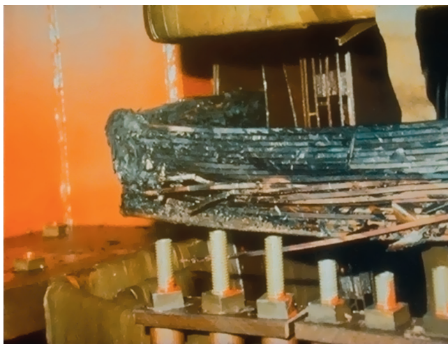
Одно из опасных последствий геомагнитной бури 13 марта 1989 года – выход из строя повышающего трансформатора на атомной электростанции в Нью-Джерси. Источник: https://science.nasa.gov/science-news/science-at-nasa/2010/26oct_solarshield
