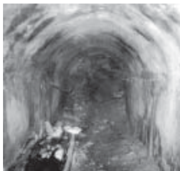
Фото 4. Ход оштукатурен, на стенах — пятна копоти, ржавые потеки, на полу — металлическая труба
