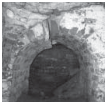
Трещина в своде погвально-го тоннеля возникла, вероятно, в 1964 году при взрыве Николаевского собора (бывшего костела св. Стефана)
