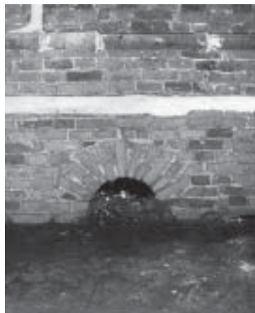
Подвальный дренаж Фото А.Г. Буховецкого
