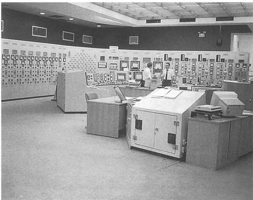
Производство без людей: атомная электростанция.
