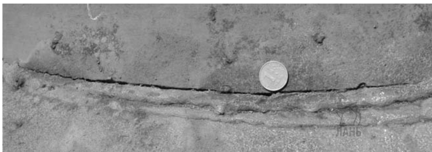
Рис. 32. Разрушение кольцевого сварного шва, возникшее через несколько лет после начала эксплуатации — трещина развилась из несплавления, допущенного при сварке
