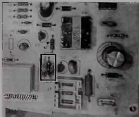
Рис. 13. Подгорание резистора R18 в цепи УБЛ и участка платы силового модуля
